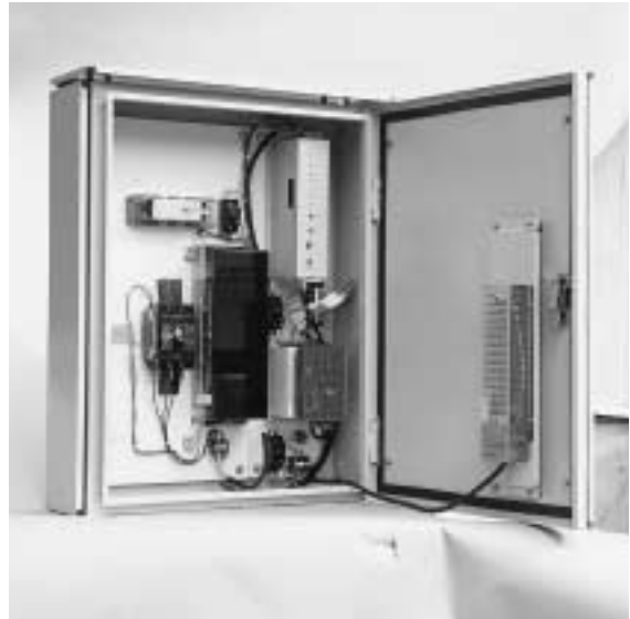
写真1 “雷丈夫”の外観 Photo.1 Overview of "Raijobu" system
