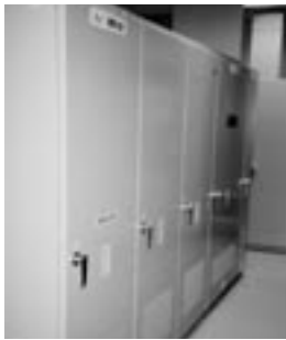
写真 1 100kVA UPS 外観
