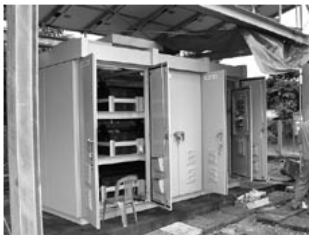
点検状況 (Battery Checking)
