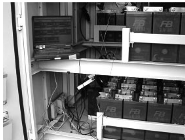
蓄電池 (Battery Module)
