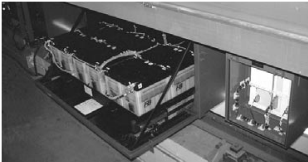
図 3 艦装されたバッテリー (左) とバッテリー状態監視装置 (右) Fig.3 Ni-Cd monoblock batteries (left) and monitoring system (right).
