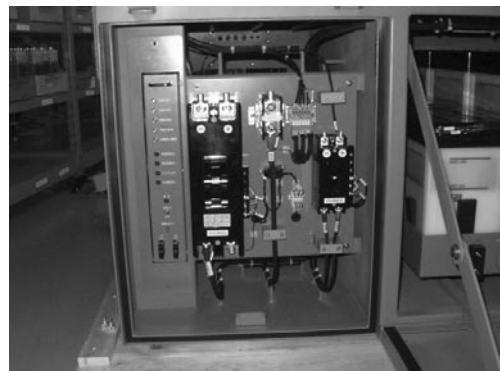
写真2 筐体に組み込まれた状態の監視装置(左側)
