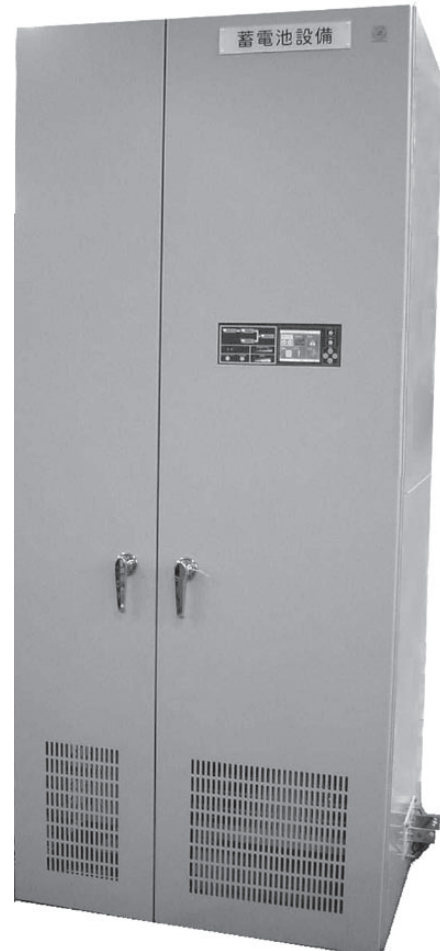
写真 1 MD2100 形整流器 Photo.1 MD2100 type rectifier
