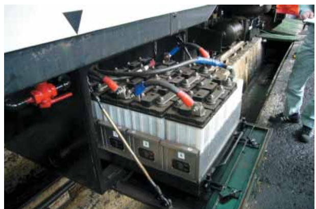
写真3 1年経過後の搭載状況 (2007年4月) Photo 3 Battery condition after one year
