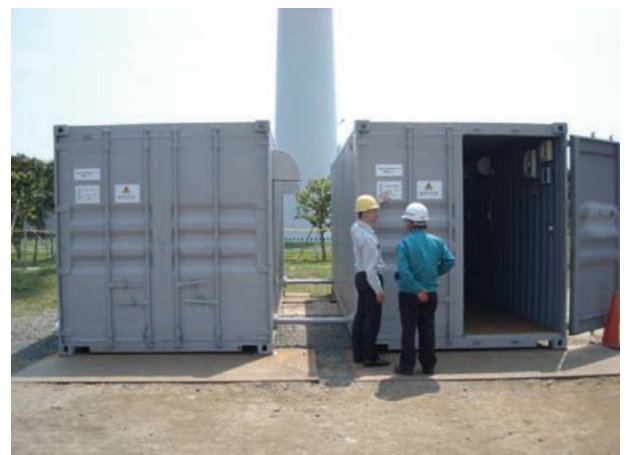
図2 コンテナ（左：蓄電池群、右：電力変換装置） Fig.2 Container (Left : Battery Strings, Right : Inverter)
