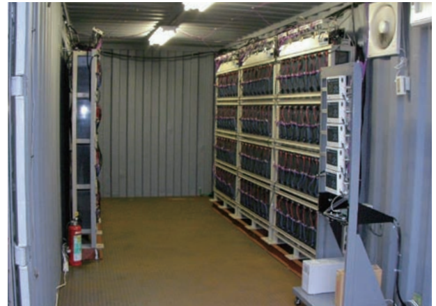
図 3 蓄電池群 Fig.3 String of Batteries
