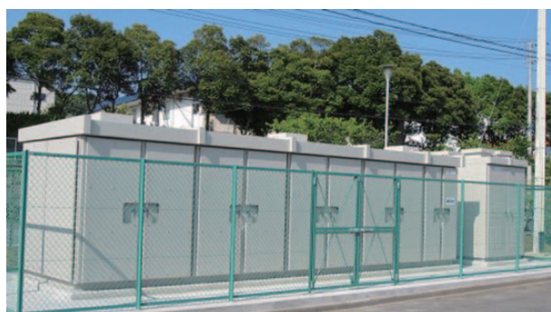
図1 蓄電システム （左：電池収納盤 右：充放電装置）
